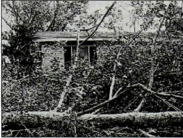
The religious education building/parish hall of St. Paul's Church in Raleigh, the mission of Magee, suffered damage when a falling tree hit the front of the building, ripping off the electric meter and pan of the roof. // El edificio para educación religiosa/salón parroquial de la Iglesia de San Pablo en Raleigh, la misión de Magee, sufrió daños cuando un árbol cayó sobre la fachada del edificio, arrancando el medidor eléctrico y parte del tejado.
